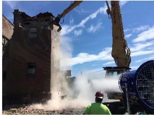
La construcción y la demolición son ser fuentes de emisiones de materia particulada
